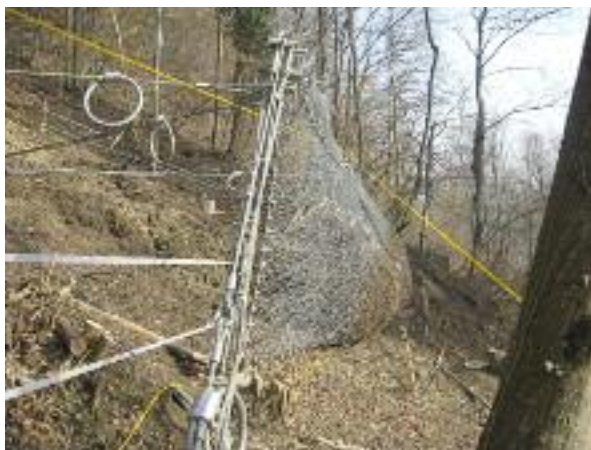
Abb. 11: GEOBRUGG - Schutznetz gefüllt mit Schutt.
